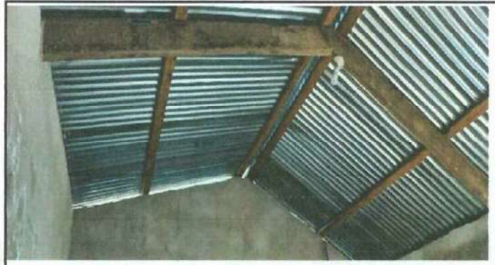
Foto 2: Se observa la necesidad de sustituir la cubierta de lámina
