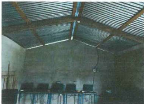
Foto 3: Se observa la necesidad de levantar una pared de block para separar el aula de computación con la bodega
