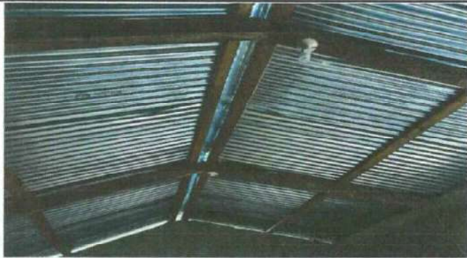
Foto1: Se observa la necesidad de sustituir la estructura de madera del techo, por estructura metálica.
